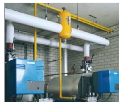
Utilitätsinstallation mit einem Luftabscheider versehen
