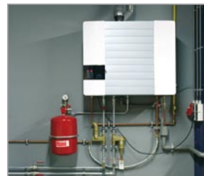
Individuelle Luft- und Schlammabscheider in einer Wohnhausinstallation
